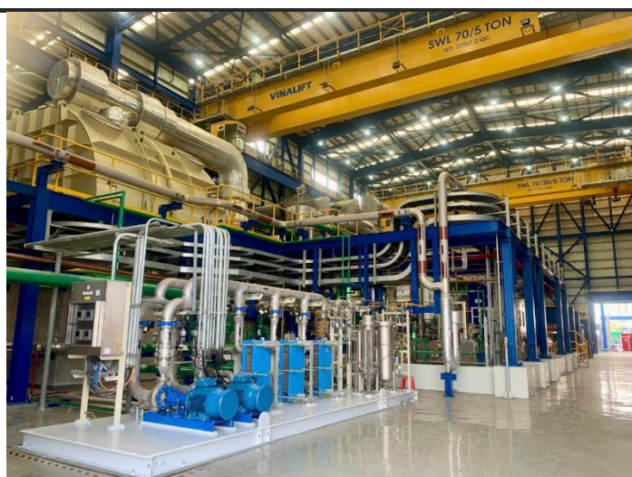
Hình 3: Nhà máy điện khí LNG NT3&4
