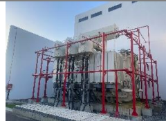
Máy biến áp 220kv
