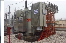
Máy biến áp 110kv
