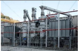
Máy biến áp 500kv
