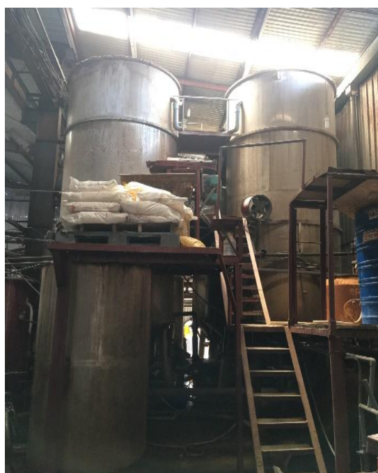
Tháp lắng bột
