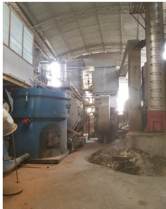
Hệ thống nồi hơi
